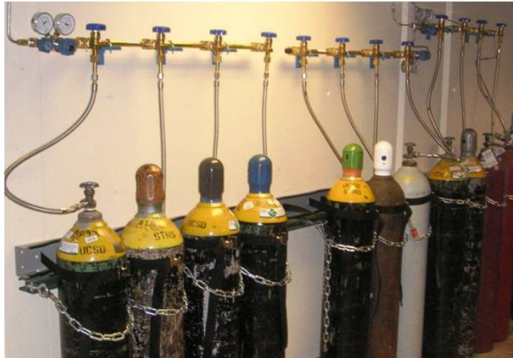
Abbildung 4: Gaszylinder verbunden über flexible Hochdruckleitungen mit Druckgasverteiltern.
